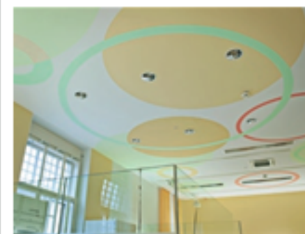
Abb. 5: Die Decken in den Behandlungs- und Patientenzimmern wurden ansprechend farbig gestaltet, wobei die zahlreichen technischen Einrichtungen optisch integriert wurden.
